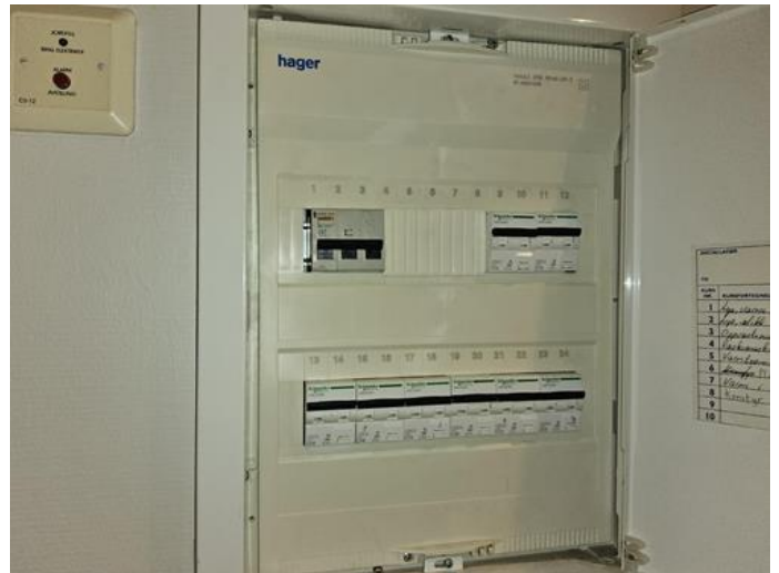
Elektrisk anlegg - [Sikringsskap. ]
