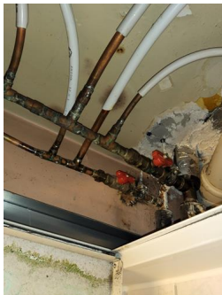
Vannrør - Rørkoblinger over inspeksjonsluke.
