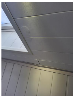
Overflate himling - Svelleskader i skråtaket på soverom 1
