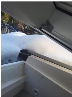
Takvinduer - Snødekte flater på befaringstidspunktet
