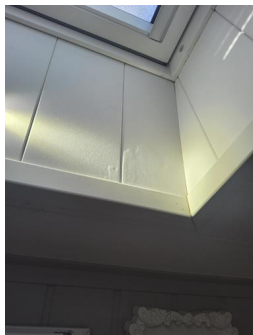
Takvinduer - Svelleskader ved takvindu
