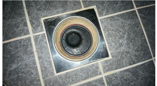
Bildet viser sluk.
