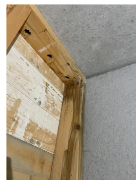
Bilde viser fuktmerker i yttervegg bod på balkong.
