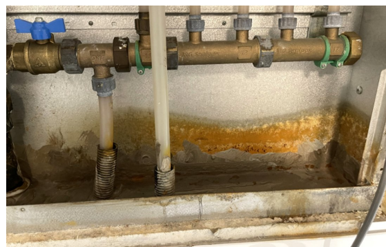
Rust i nedre del av vannskapet
