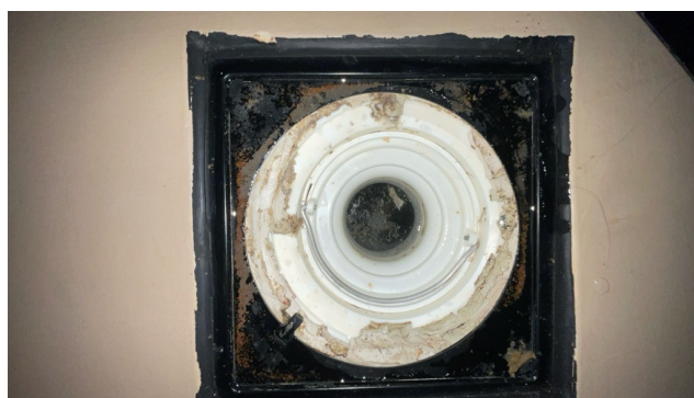
Bildet viser sluk.
