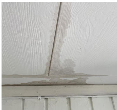
Fuktmerker i tak i vindfang
