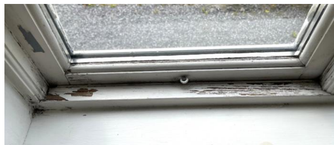
Eksempel på malingsslitasje i karm
