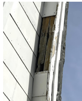
Manglende eternitplater i kiste mot syd.
