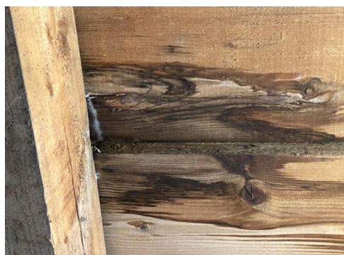
Fuktmerker i taktro ved pipe.
