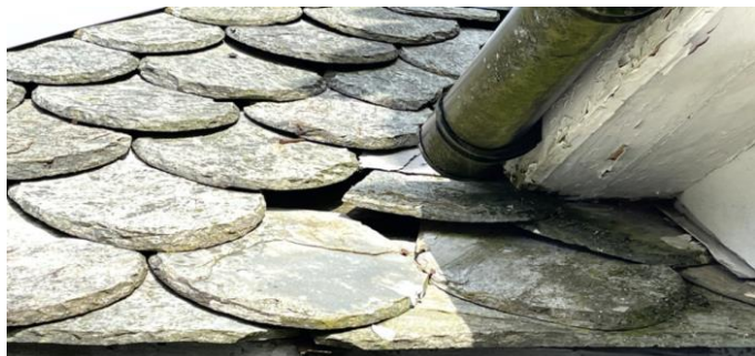
Årsaken til lekkasjen
