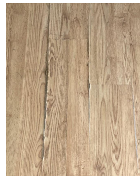
Eksempel på fuktsvelling i laminatskjøter
