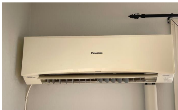
Varmepumpe (innedel) i 2. etasje
