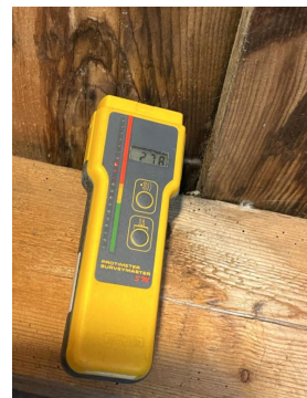
Det ble målt høy fukt i treverk v/pipe
