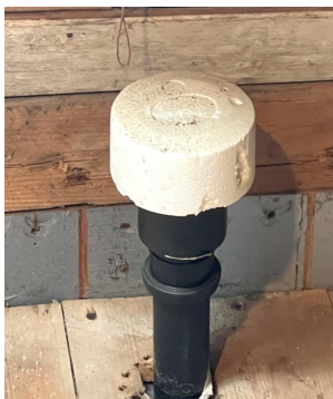
Lufteør for kloakk stanser på kaldloftet
