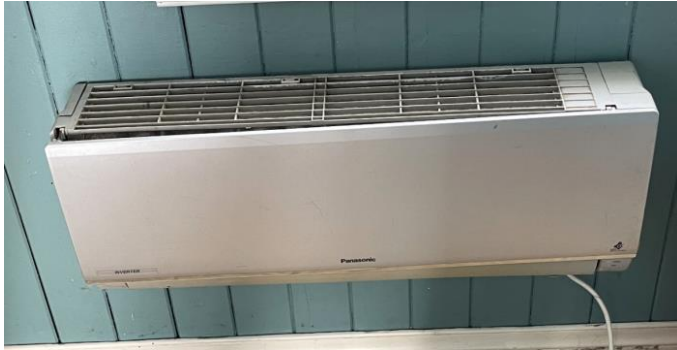
Varmepumpe (innedel) i 1. etasje.
