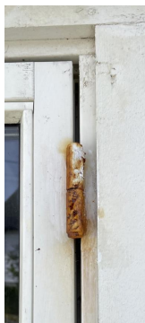
Eksempel på rustne hengsler på kjøkkenvindu
