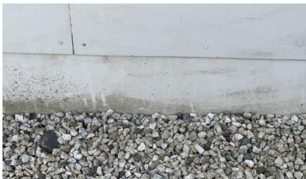
Ingen avstand mellom yttervegg og terreng mot nord.
