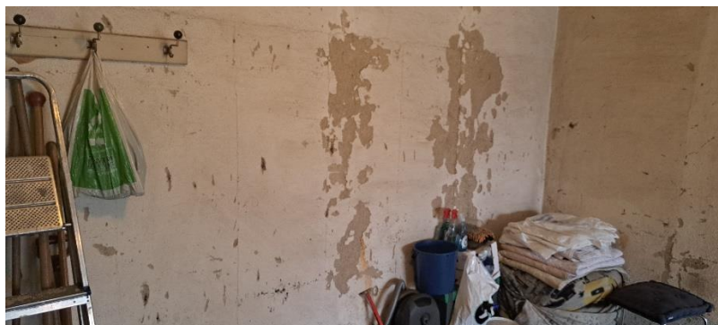
Bilde 10: Bakre vegg, isolasjonslag av betongfiber matter, kosmetiske skader
