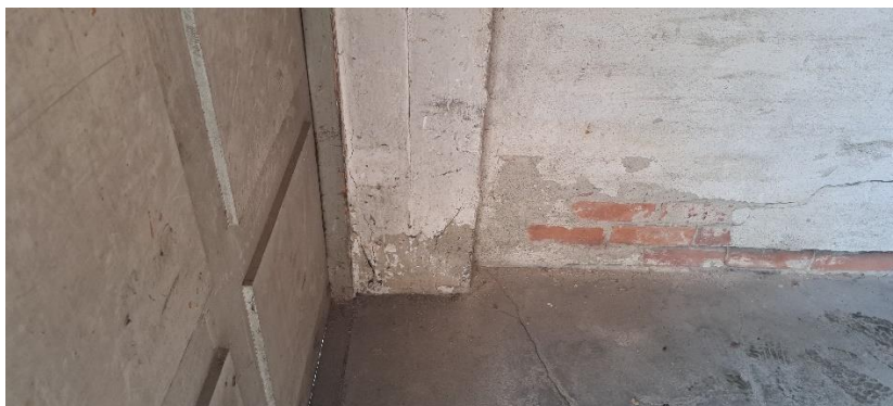
Bilde 12: Firkantet søyle Sprekker flere plasser.
