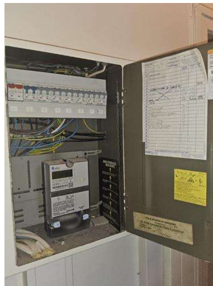
Elektrisk anlegg - [Sikringsskap og kursfortegnelse ]
