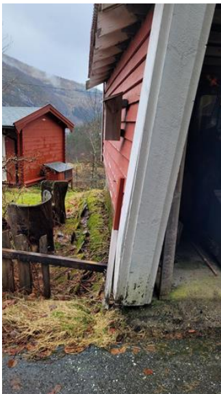
Utvendig - [Skjevheter grunnmur garasje.]
