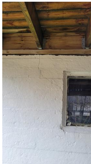
Utvendig - [Sprekk i grunnmur.]
