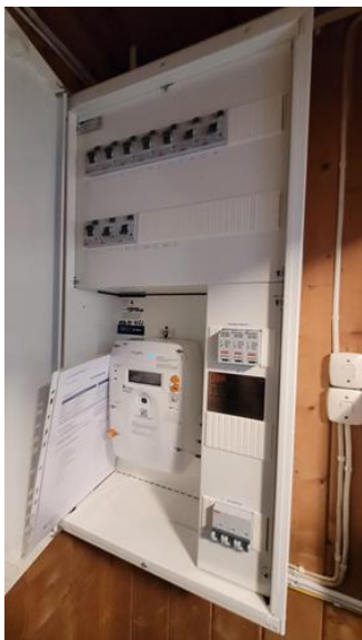
Elektrisk anlegg - [Sikringsskap.]
