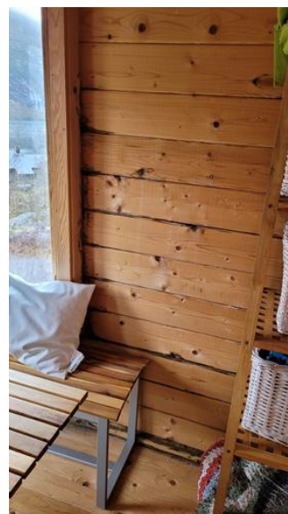
Utvendig - [Fuktskade frittstående uthus.]
