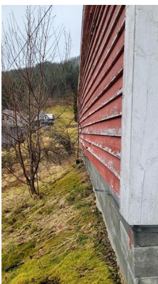
Utvendig - [Skjevheter grunnmur garasje.]
