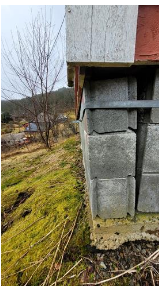
Utvendig - [Skjevheter grunnmur garasje.]
