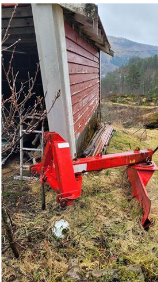
Utvendig - [Skjevheter grunnmur garasje.]
