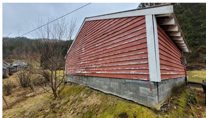
Utvendig - [Slitasje på yttervegg.]
