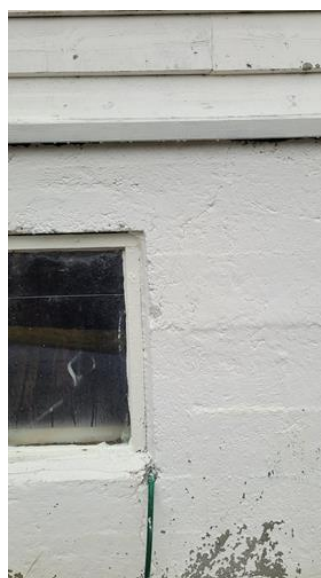
Utvendig - [Sprekk/riss i grunnmur.]
