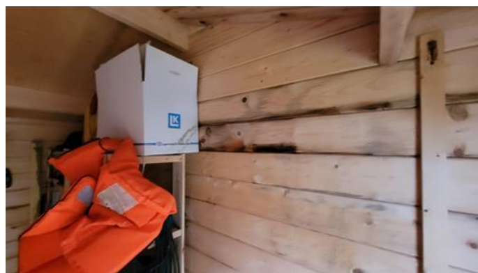
Utvendig - [Fuktskade frittstående uthus.]
