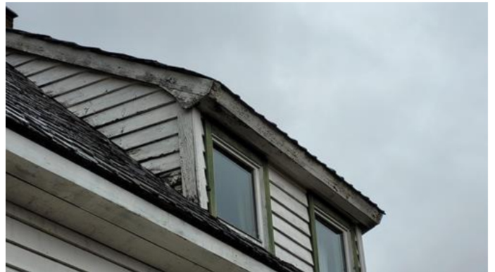
Utvendig - [Slitasjetegn på kledning.]
