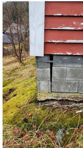
Utvendig - [Skjevheter grunnmur garasje.]
