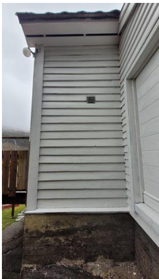
Utvendig - [Slitasjepreg kledning.]
