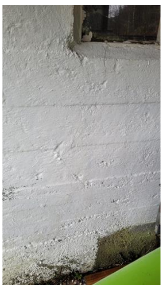
Utvendig - [Sprekk i grunnmur.]
