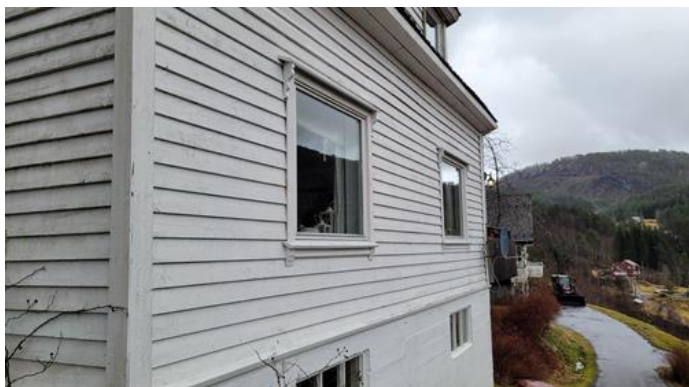
Utvendig - [Slitasjetegn kledning.]
