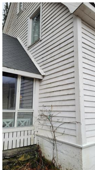
Utvendig - [Slitasjetegn kledning.]
