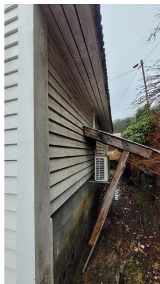
Utvendig - [Slitasjepreg kledning.]
