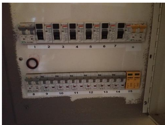
Elektrisk anlegg - [Sikringskap. ]
