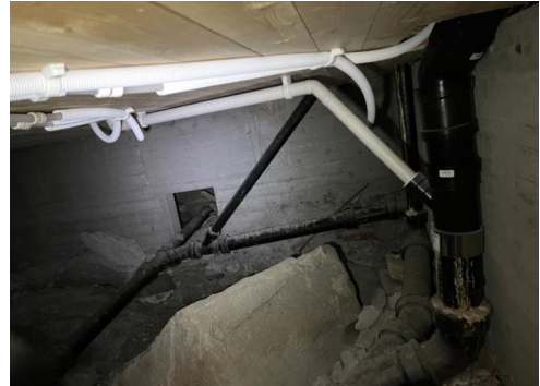
Avløpsrør i plast og støpejern i krypkjeller
