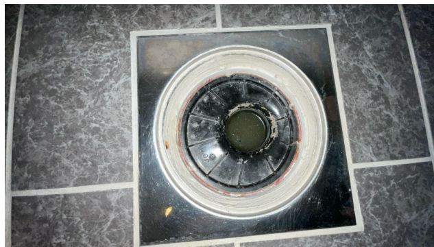
Bilde viser sluk.
