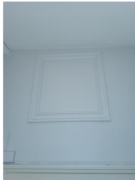
Kommentar - [Adkomst varmtvannsbereder over himling på bad. ]
