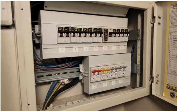
Elektrisk anlegg - [SiSikringsskap ]
