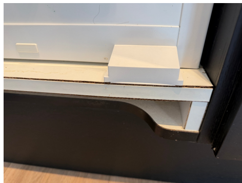
Det bemerkes svelleskader i bunnplate under fryser.
