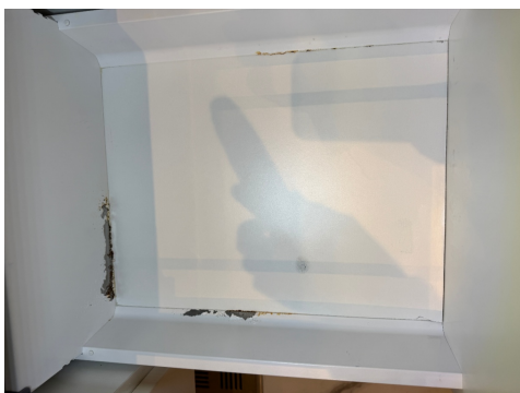
Rust/løsnet maling i en skuff
