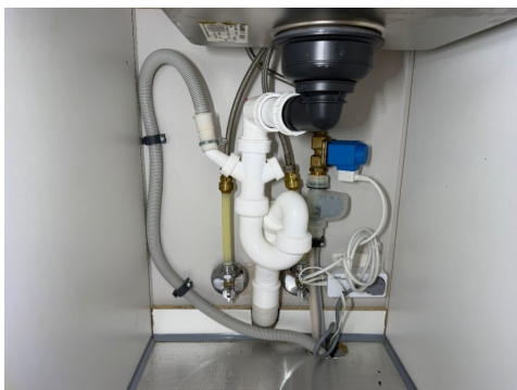
Røropplegg i kjøkkenbenk
