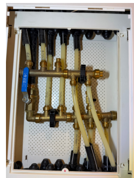
Rørskap i baderomsvegg med stoppekran.
