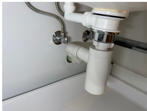
Røropplegg i servantskap
