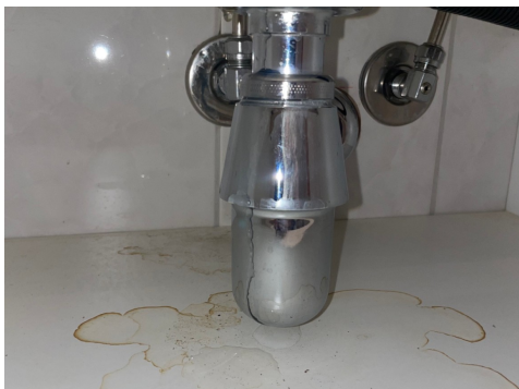
Bildet viser lekk vannlås.
