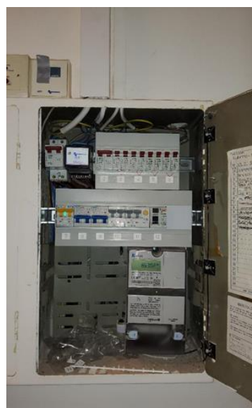
Elektrisk anlegg - [Sikringsskap ]
