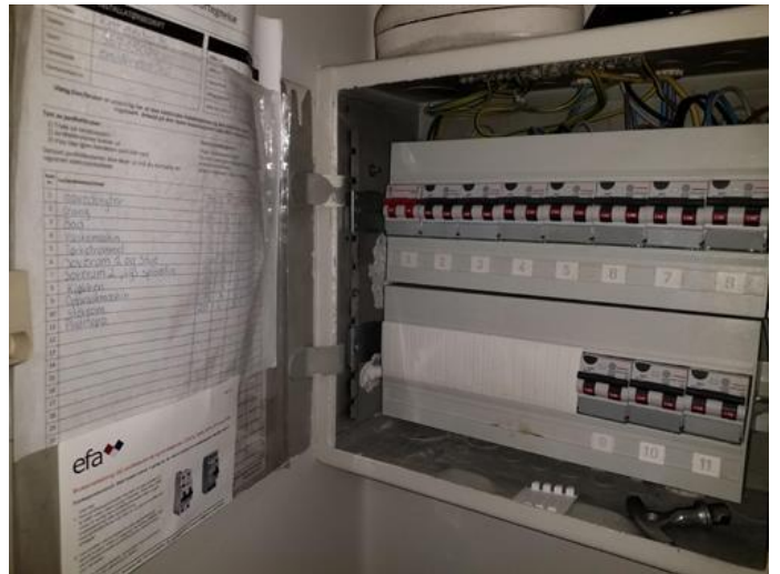
Elektrisk anlegg - [Sikringsskap ]
