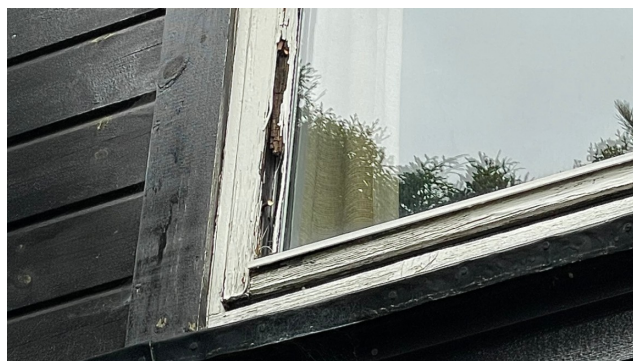
Bildet viser råteskadet vindu i spisestue.
