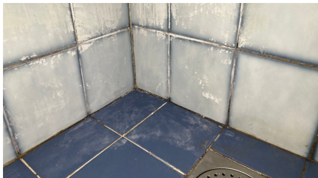
Bildet viser løse/sprukne fliser/fuger i dusj.
