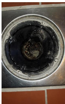
Tettesjiktets tilslutning til sluk - Sluk vaskerom
