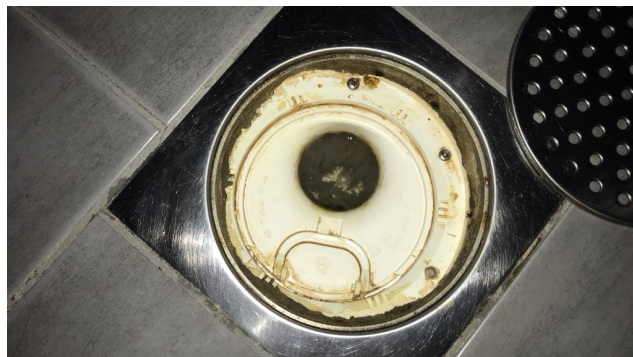
Bilde viser sluk
