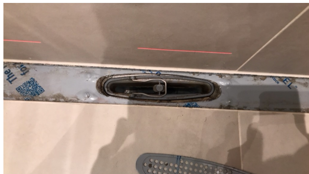
Bilde viser sluk i dusj
