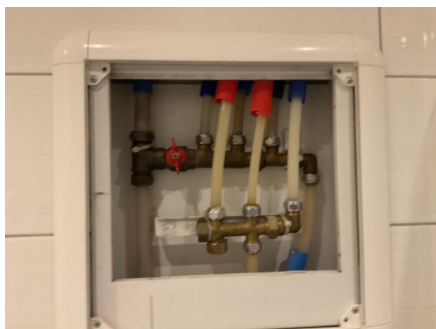
Fordelerskap med stoppeventil
