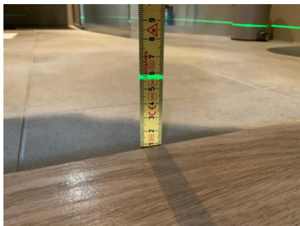
Høydeforskjell (flis ved terskel)
