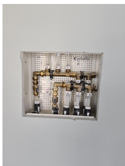
Fordelerskap og fordelerstammer - Fordelerskap
