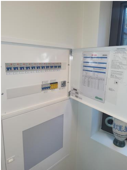
Elektrisk anlegg - [Sikringsskap ]
