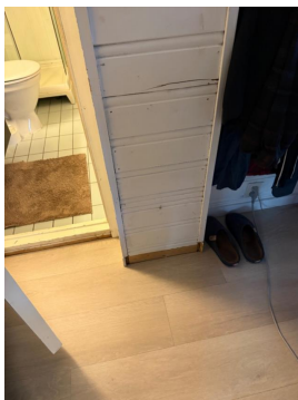
Hovedstoppekran til kjellerleilighet bak veggpanel.
