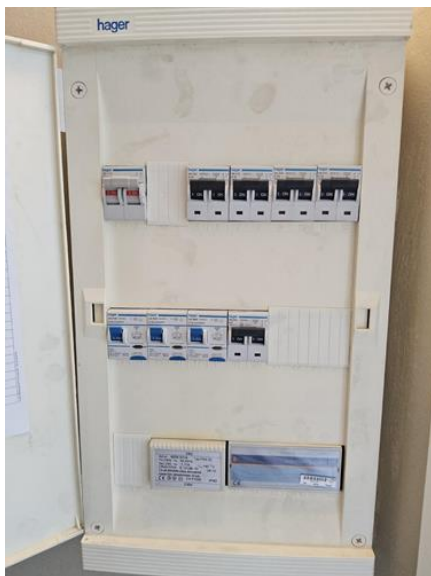
Elektrisk anlegg - [Sikringsskap. ]
