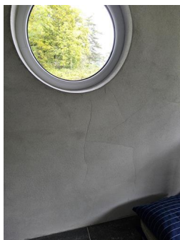
Overflate vegg - Sprekker i murpuss underetasjen
