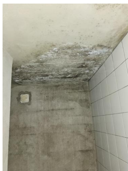
Overflate himling - Fuktmerker og løst murpuss
