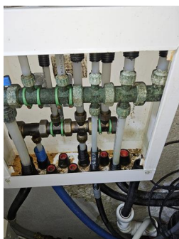
Fordelerskap og fordelerstammer - Fordelerskap
