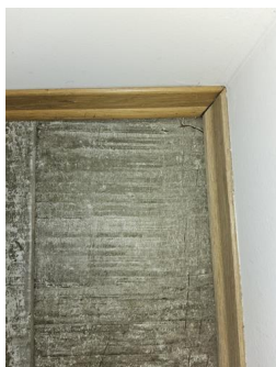
Overflate gulv - Sprekk flis entré
