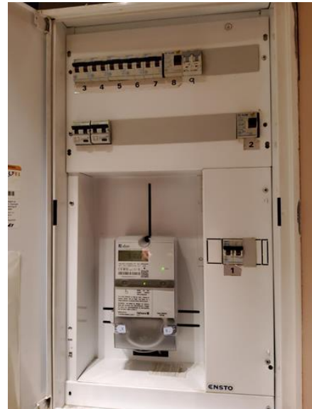
Elektrisk anlegg - [Sikringskap]
