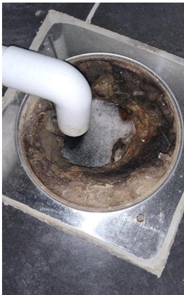
Avløpsrør (ink. sluk) - [Sluk på bad]
