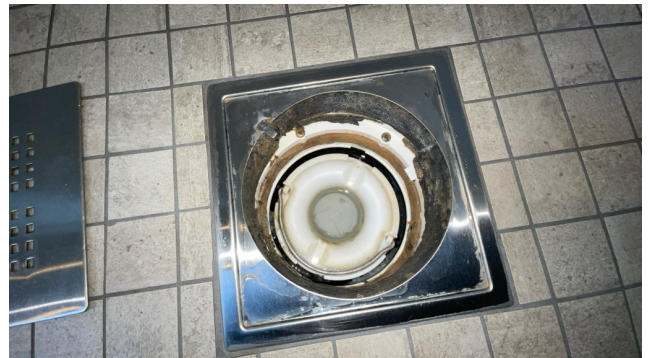
Bilde viser sluk
