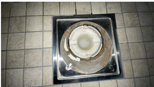
Bilde viser sluk
